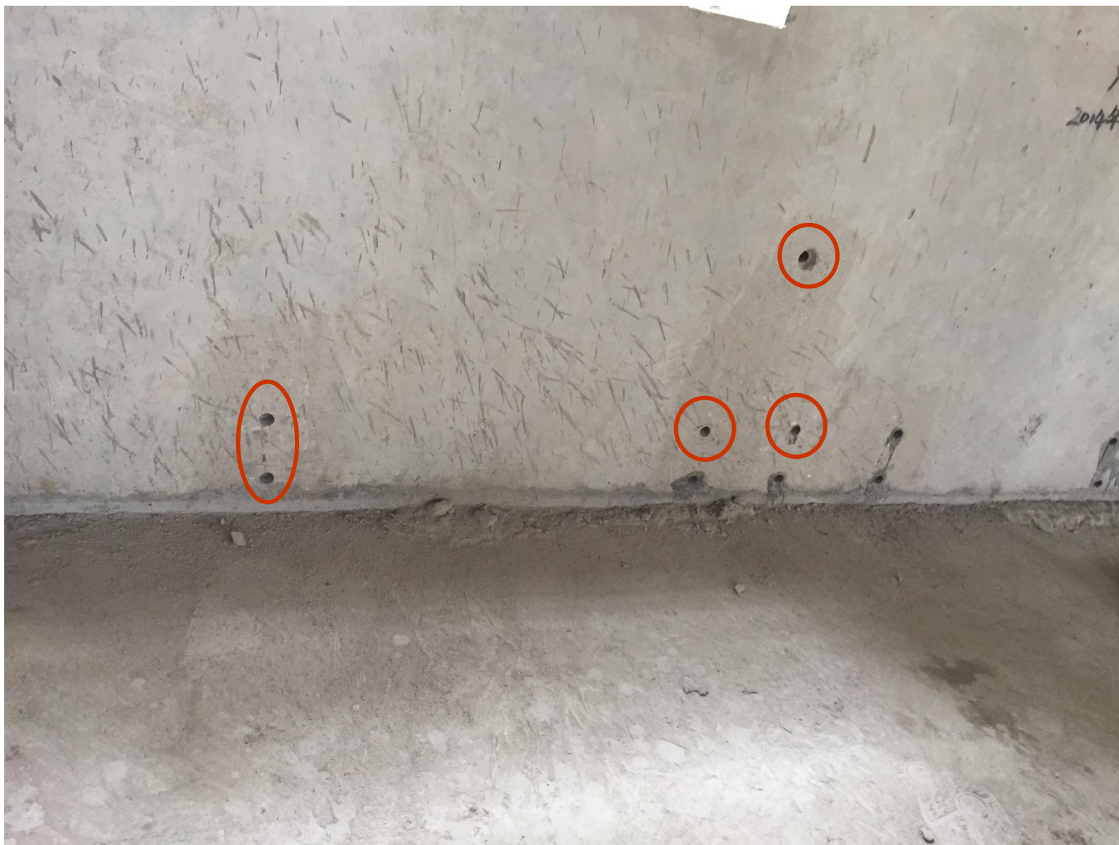
部分出浆孔(上部一排孔)未见浆液冒出痕迹
